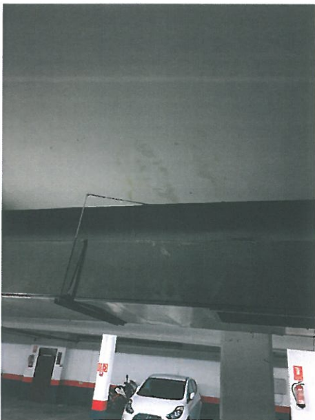
Humedad en techo plaza 63.
