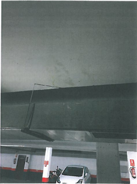
Humedad techo plaza 105
