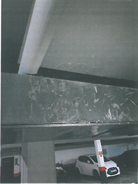
Humedad en techo plaza 65
