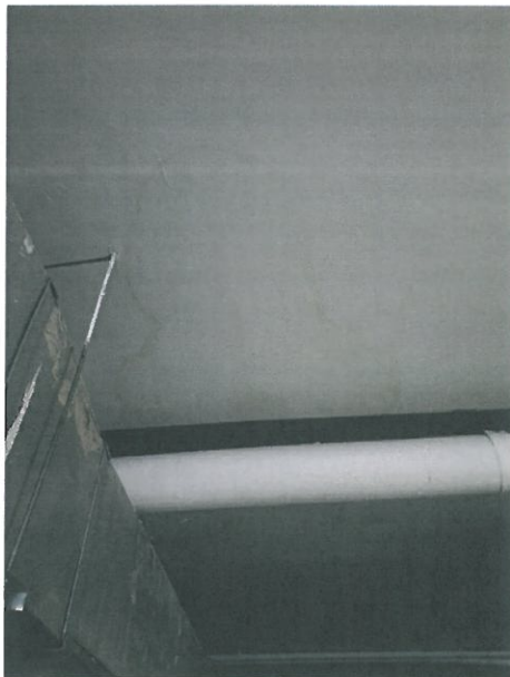
Humedad en techo plaza 68
